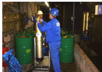
Spülung des Schmieröl- und Steuerölkreises einer Turbine
